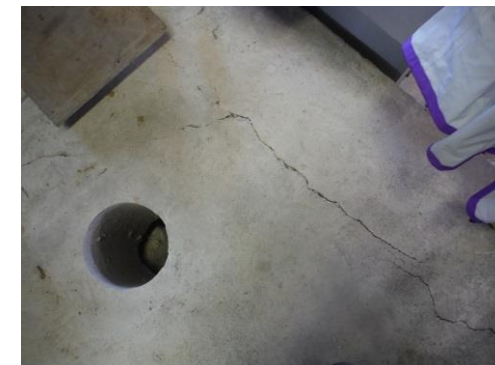
機場内のひび割れ
