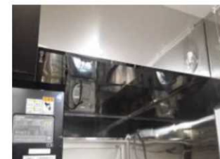
空気換気設備 （調理場）
