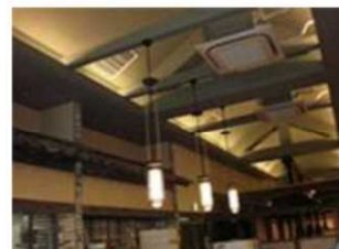
空気換気設備 （店内）
