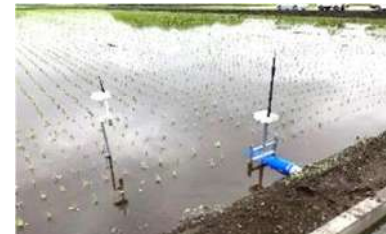
水位センサーと自動給水栓による水管理
