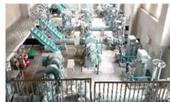
塩田揚水機場(芳賀台地土地改良区)
