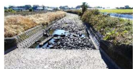
改修が待たれる幹線水路
