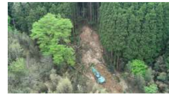
漏水により崩落した山斜面
