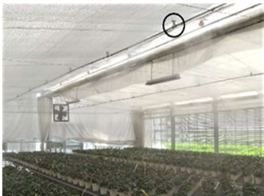
稼働中の細霧冷房
