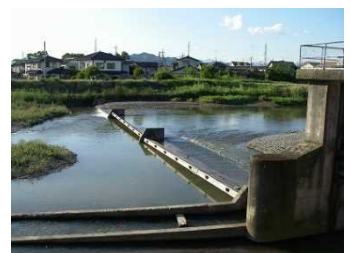
改修前の赤坂堰 (転倒不具合の様子)
