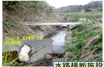
水路横断施設
