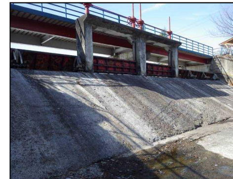
維持管理に支障を来している余水吐ゲート
