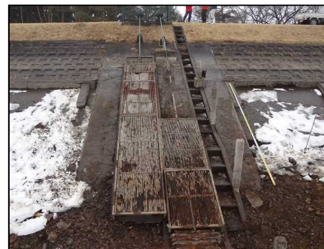
老朽化した取水施設
