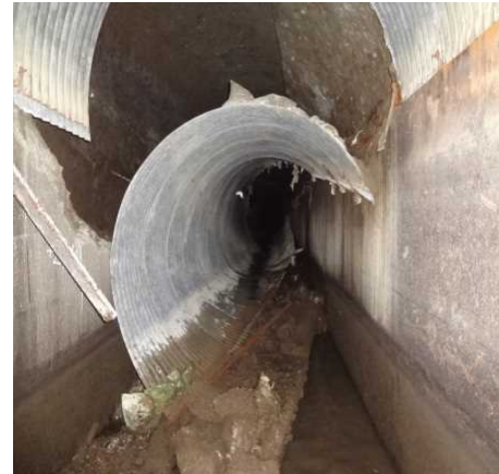
崩落した隧道(H28改修予定)
