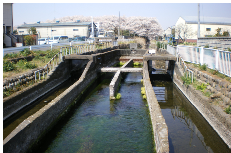
写真1 横手・ミケ村分水工（足利市）
