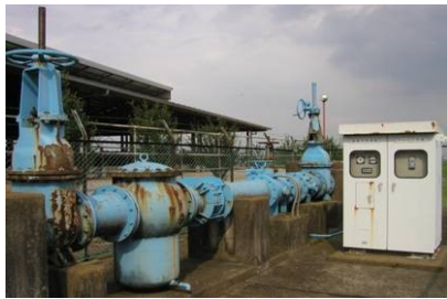
写真 1-1 老朽化による機能低下
