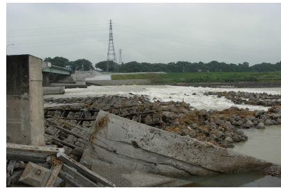
写真 1-2 河床低下により倒壊の危険がある堰
