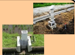
ICT水管理システムの機器
