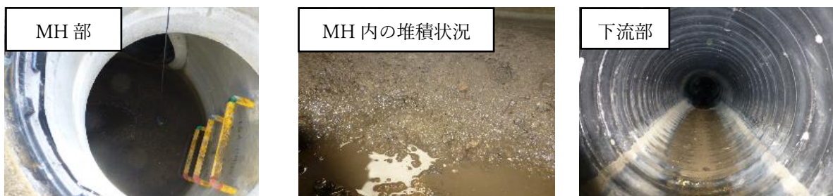
図 5-6-8 インバートなしのマンホール内（土砂堆積あり）及び下流の暗渠管の状況（荒井町島地区）
