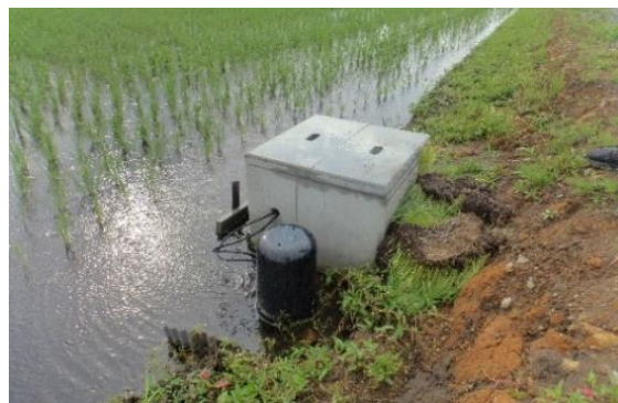
大区画化と併せて用水路をパイプラインと自動給水栓で整備し、一層の省力化を図っている
