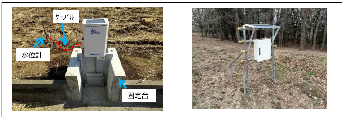
図 5-2-2 自動給水栓と基地局（栃木県農業大学校に設置されたもの）
