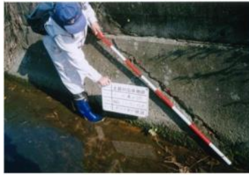
写真3 2次診断 ひび割れの確認
