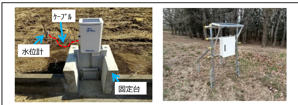
図 5-2-2 水管理システムと基地局（栃木県農業大学校に設置されたもの）
