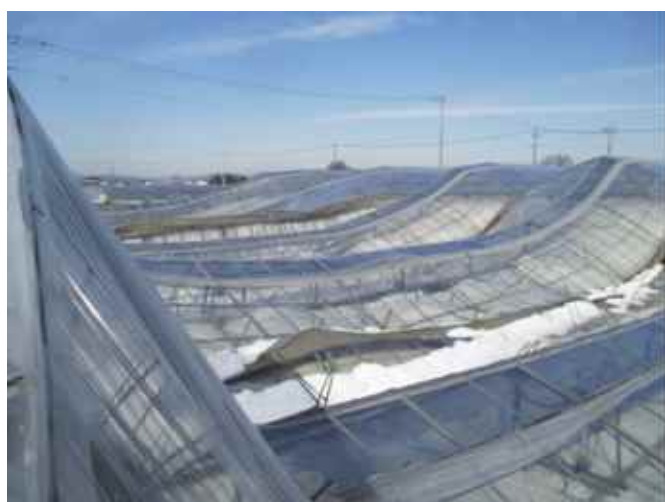
積雪荷重で柱から倒壊したハウス。トマト収穫が始まったばかりだった。
