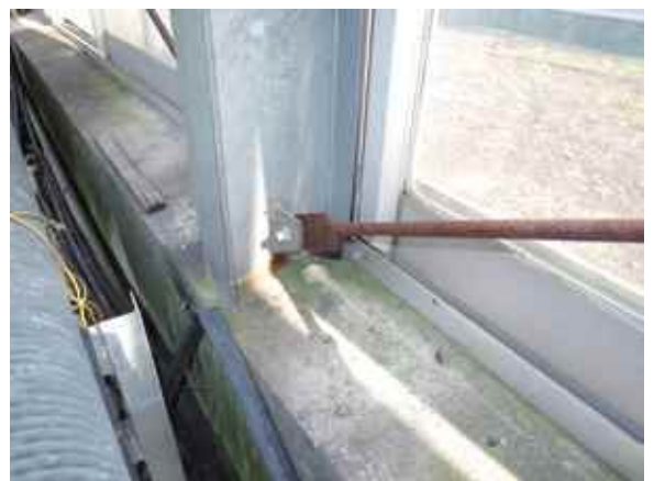
ブレースには著しくサビが生じているが主骨材にはない。
