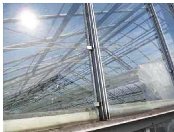
ガラスを固定する留め具が劣化し、一部にガラスの破損も見られた。
