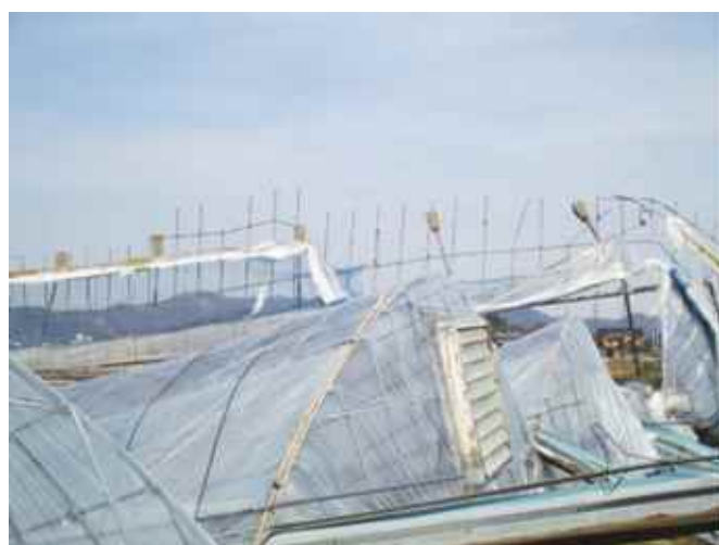
基礎部の置石ごと抜けた雨よけぶどうハウス。
