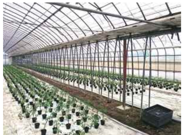
柱が途切れている部分は強度が弱く柱による補強がなされていた。
