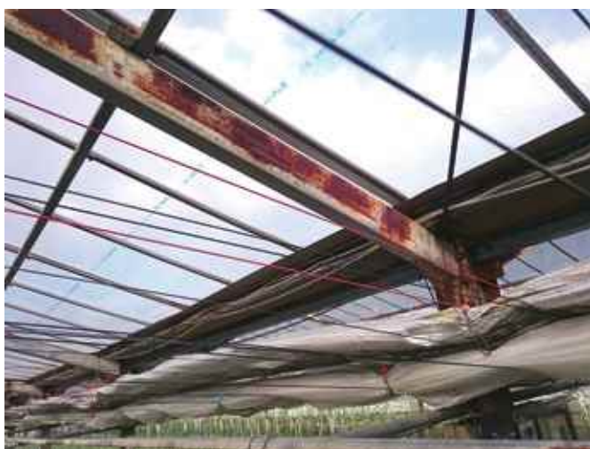
主骨材にサビが生じているため、サビを落とし塗装が必要。
