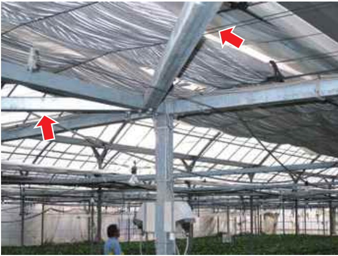
妻面と中柱・水平ばりの間をトラスでしっかりと支えられていた。
