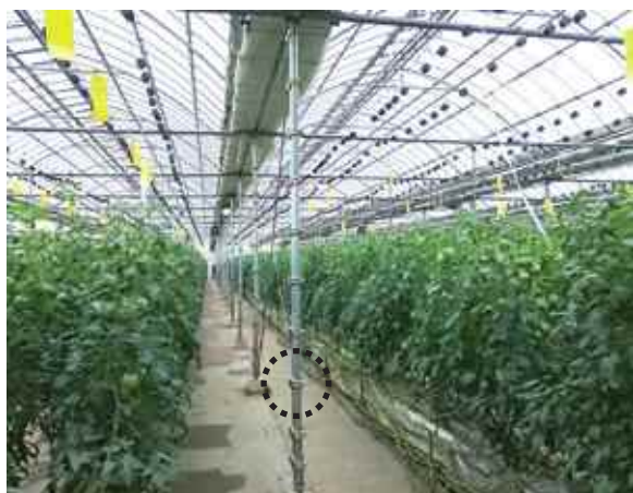
既存の柱に補強のためのパイプがクランプで固定されている。
