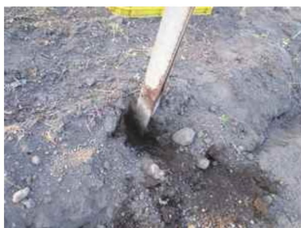
柱と基礎の接合部分が埋没し、柱に著しいサビが生じていた。
