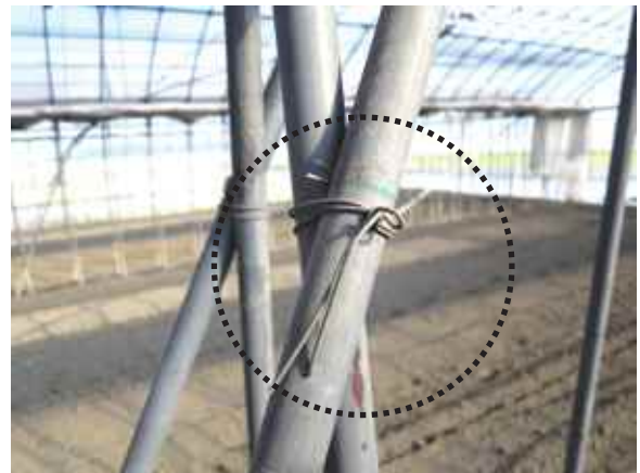
筋交いは針金でパイプと固定されており、十分な補強は期待できない。
