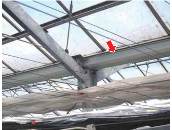
最もサビが生じやすい雨樋にアルミを使用している。 (平成10年頃からアルミ素材が使われ始めた)
