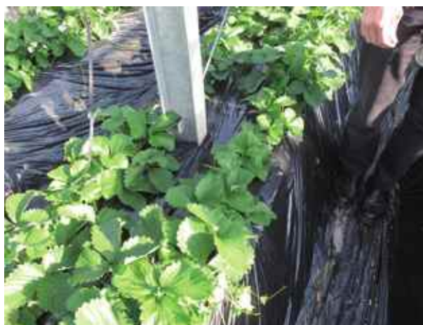
作土中の畝間に設置された谷柱とその基礎。設計当時の地耐力はない。
