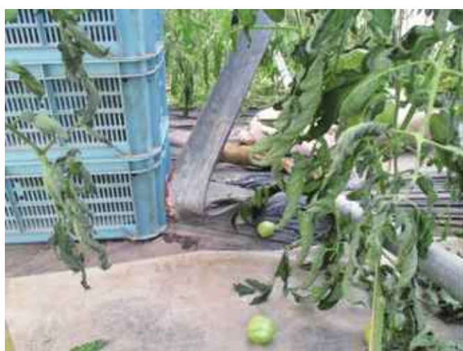
L形鋼(アングル)は雪の荷重に耐えられず完全に開いてしまい、折れ曲がった。
