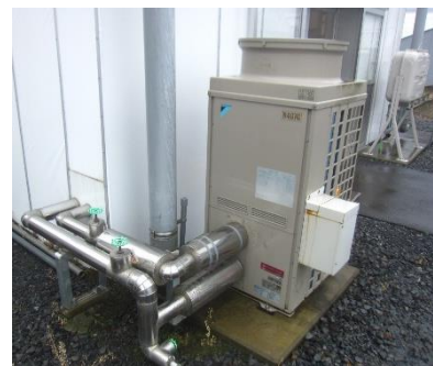
図 29 ヒートポンプ
