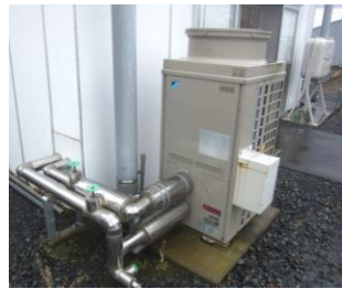
ヒートポンプ
