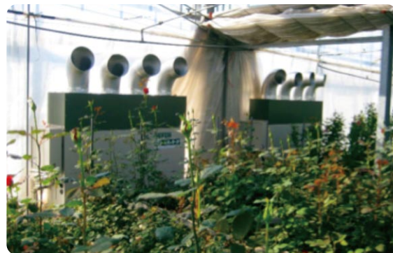
ヒートポンプの使用によるCO2の排出削減
