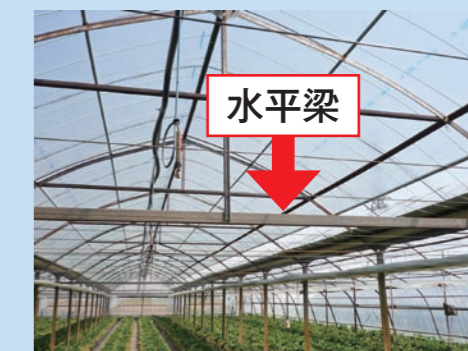
このハウスは温度が確保され、水平梁も有していたので大雪の被害を免れた
