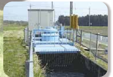
農業用水路の小水力発電施設(那須塩原市)
