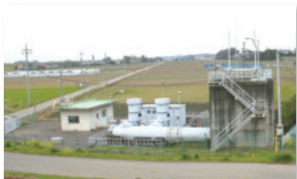
保全対策工事を待つ間々田乙女排水機場 (小山市、野木町)
