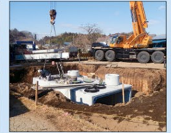
整備が進む防火水槽
