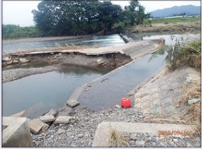
被災した取水堰
