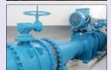
小水力発電施設
