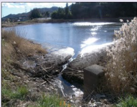
整備前 漏水や変形を生じている 堤体・護岸
