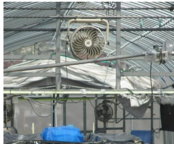
循環扇の設置状況
