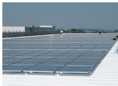
物流倉庫 150kw システム
