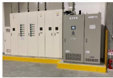
非常用蓄電池設備
