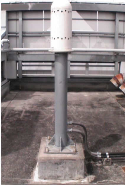
写真 (モニタリングポスト測定部)
