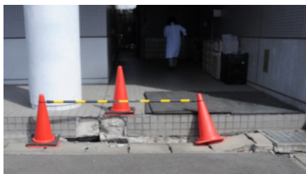
(破損した外構部分)
