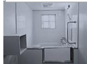
特化ユニット浴室
