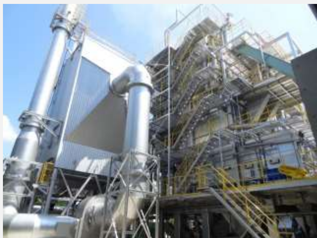
木質バイオマス発電所（那珂川町）
