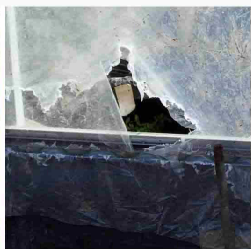
ビニールを破いて侵入
