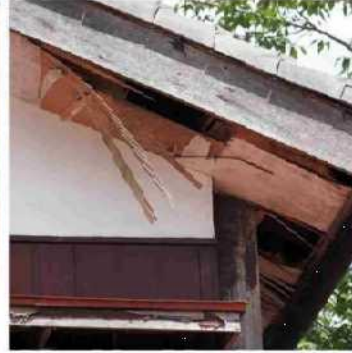
破壊された軒
