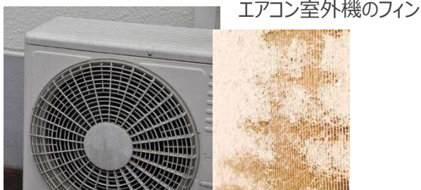
エアコン室外機のフィン
