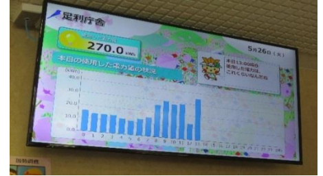
▲ 県庁舎に導入したビルエネルギー・マネジメントシステム（BEMS）
