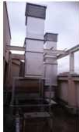
ボイラー排熱
