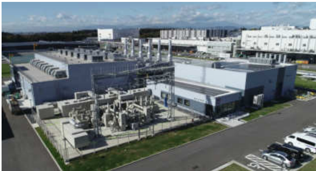
図2-4-2 清原スマートエネルギーセンター
