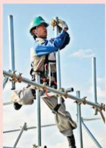
鋼管パイプ等を組み合わせ、作業用の足場を組み立てる「とび職種」
