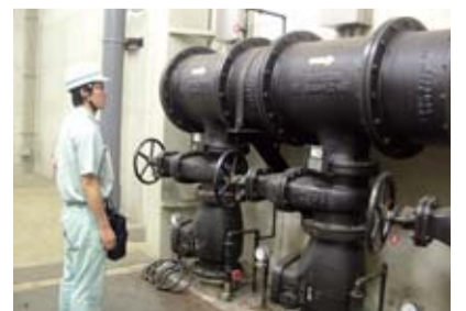
アンダーパス内の排水ポンプ点検の様子
