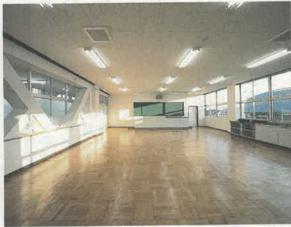
県立小山高等学校理科教室棟、筋交いを入れて耐震補強
