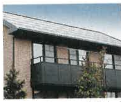
屋根に設置した太陽電池パネル
