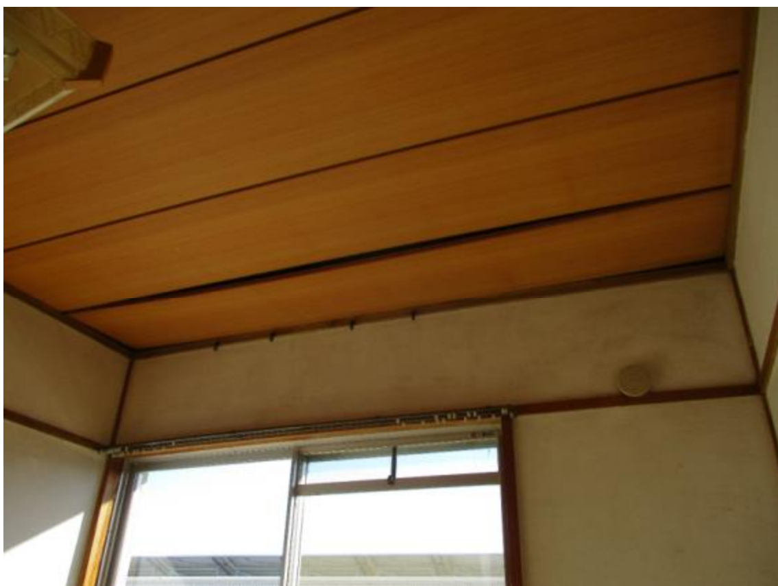
建物内にて撮影（天井劣化部）
