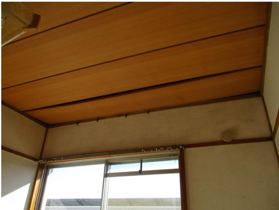
建物内にて撮影（天井劣化部）
