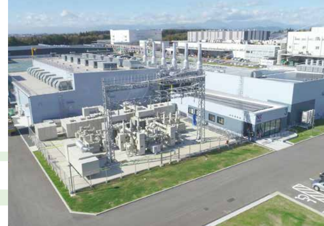
Instalação de fornecimento de energia altamente eficiente, tendo em consideração a redução das emissões de CO 2
