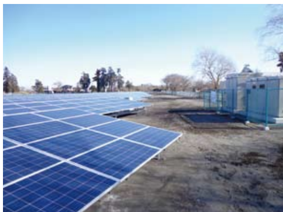
太陽光発電施設
