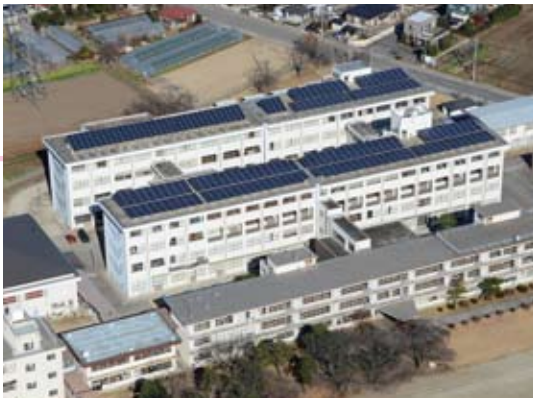
校舎の屋上を利用した太陽光発電
