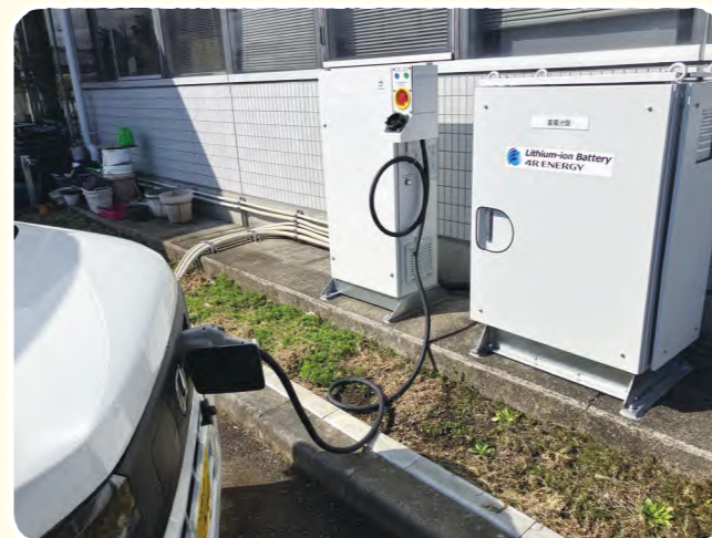
▲充電器 (V2H) と蓄電池
